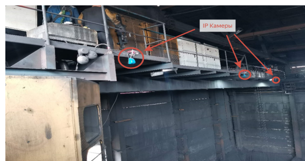
Рис. 4. Размещение IP-камер на грейферном кране
