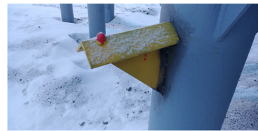
Рис. 1. Общий вид осадочно-деформационной марки
