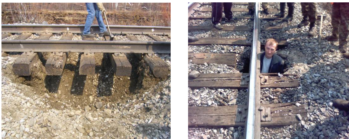
Рис. 3. Последствия протаивания инъецированного сегрегационного льда в основании земляного полотна
